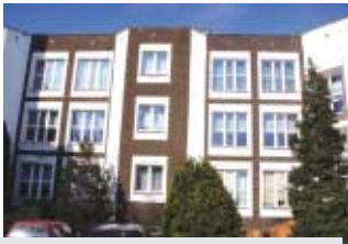
Zespół Szkół Nr 3 w Dzierżonowie w którym zostanie wykonane najwięcej prac termomodernizacyjnych m.in.: wymiana stolarki okiennej, docieplenie ścian zewnętrznych i piwnic, ocieplenie stropów i stropodachów, modernizacja systemu c.o., wymiana układu ciepłej wody użytkowej, wymiana kotłowni.
