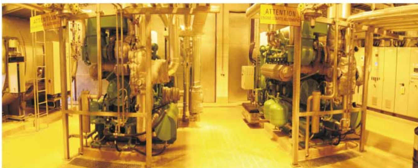
Agregaty kogeneracyjne JMS 212GS-B.L GE JENBACHER zasilane biogazem na Oczyszczalni Ścieków Bydgoszcz.
