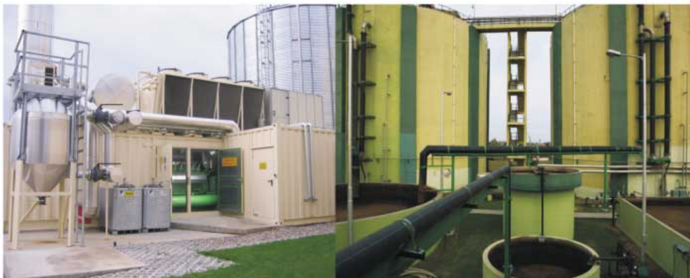
Agregat kogeneracyjny GE JENBACHER na Biogazowni Delphi w Indiach.
