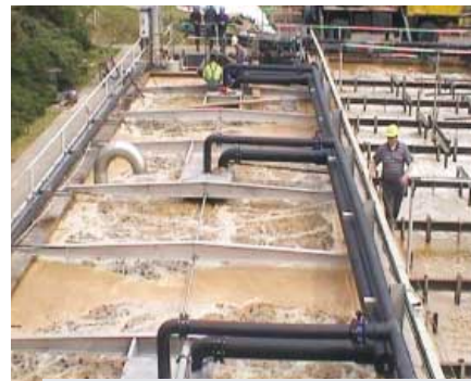
Fot. 9. Ścieki przemysłowe (chemiczne)
