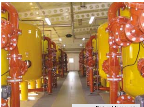
Stacja uzdatniania wody
