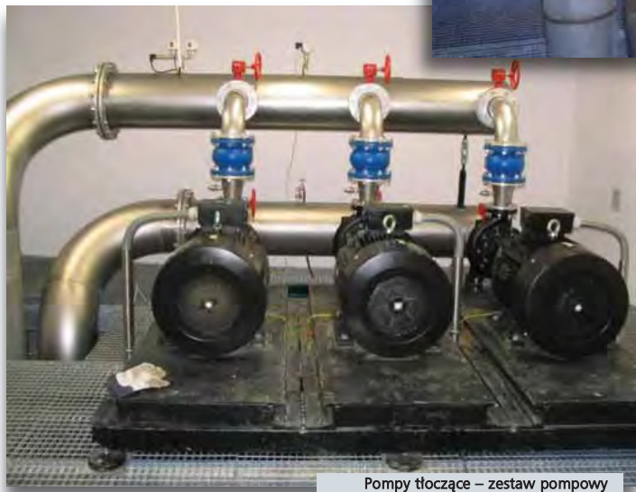
Pompy tłoczące – zestaw pompowy
