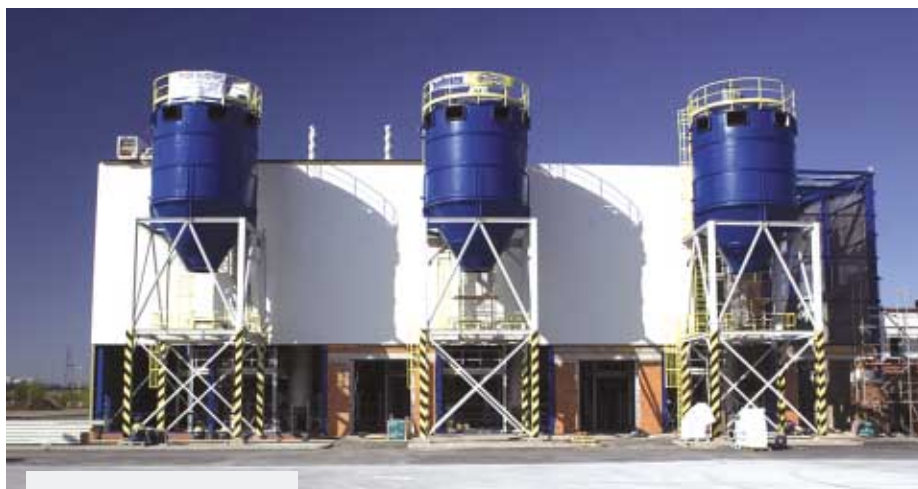
Zagospodarowanie biogazu i termiczne suszenie osadów Fot. Bogusław Biegowski, Aquanet
