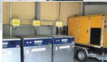
Oczyszczalnia ścieków w Piłźnie
