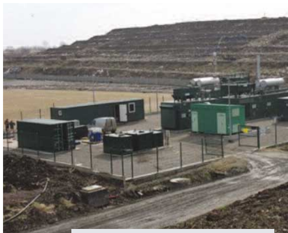
Mała Elektrownia Gazowa / MEG / 2,6 MW
