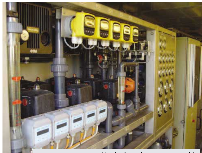
Urządzenia pomiarowe na oczyszczalni
