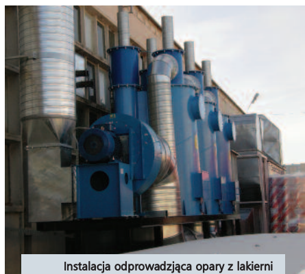
Instalacja odprowadzająca opary z lakierni
